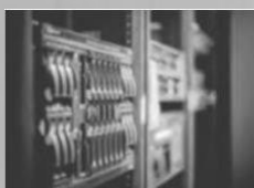
Контейнерный центр обработки данных
